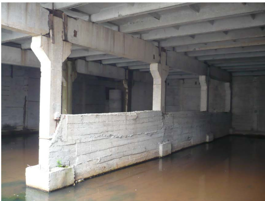
Рисунок 5.5. Общий вид резервуара воды для пожаротушения завода ООО «ЭГГЕР-Древпродукт»
